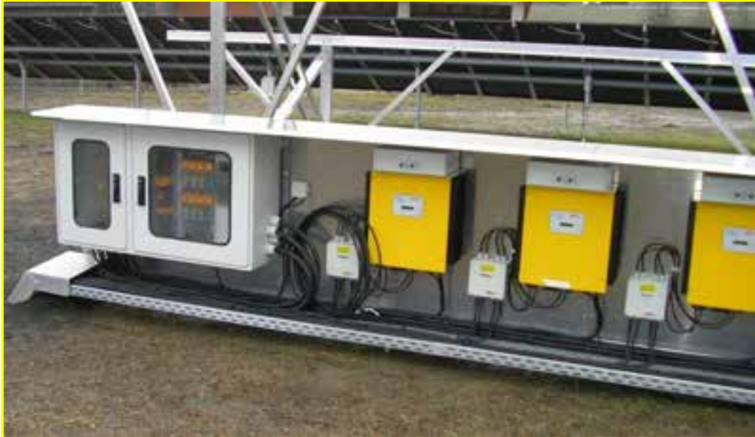
Fig. 31 - Installazione di inverter e quadro di campo sotto la struttura di sostegno dei moduli.
